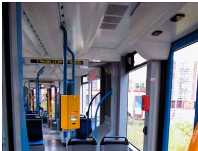
Installierte Sensoren im Fahrzeug.
