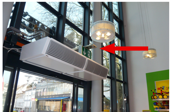
Unauffällige Installation von OptoCount
